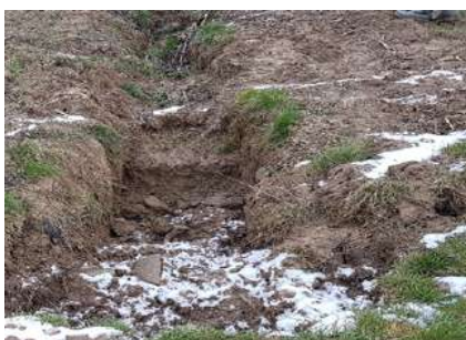
Revoir les drainages côté Muespach et Steinsoultz au Lang-Acker
